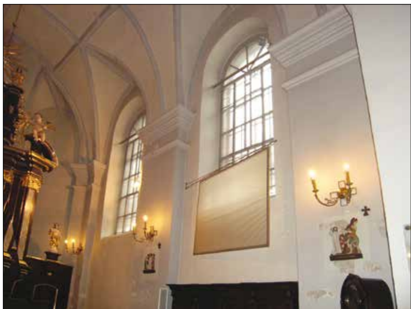
27. Lublin – kościół św. Mikołaja – pd. ściana prezbiterium z odkrywkami sondażowymi – fot. B. Stolarz 2009.
