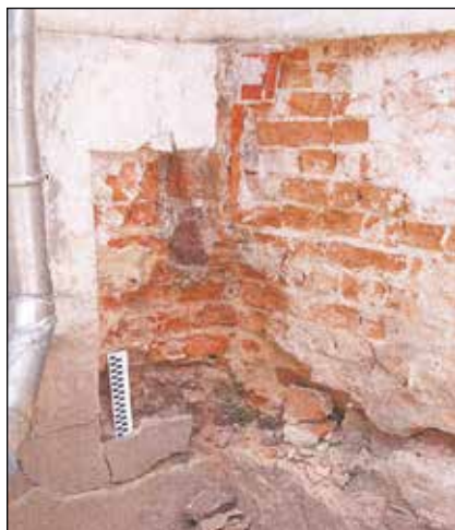
11. Elewacja frontowa, rozwarstwienie wątków muru na styku portyku z elewacją, fot. Ł. Rejniewicz, 2008.
